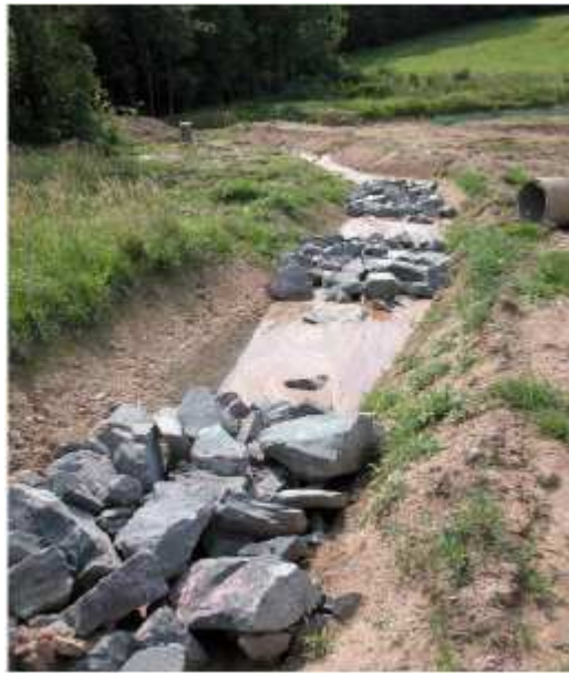
FIGURE 47 : FOSSES DE COLLECTE DES EAUX DE CHANTIER, AVEC DISPOSITIF DE REDUCTION DE LA VITESSE (BLOCS EN CASCADE) POUR LES FORTES PENTES (SOURCE : GUIDE CEREMA)
